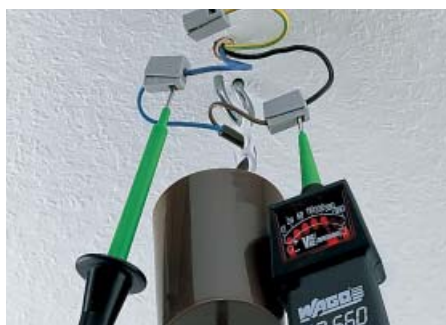
Проверка напряжения в клеммах для светильников
